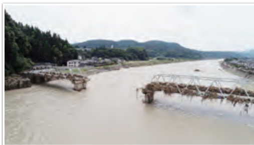
図2 流出した西瀬橋
