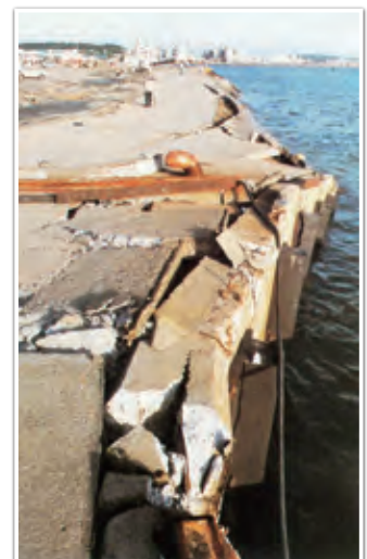
秋田港の岸壁の被害状況
