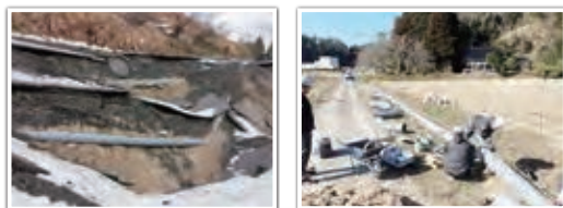
図1 上下水道システムの急所となる施設の被害状況(左:送水管、右:処理場に直結する圧送管)
