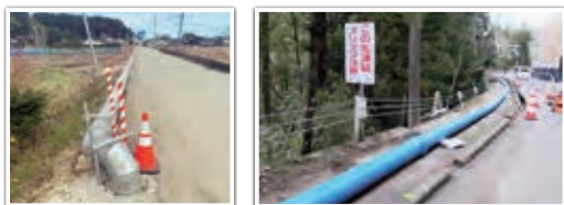
図7 仮設配管（転がし配管の活用事例）
