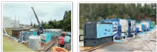
図8 可搬式浄水設備設置事例
