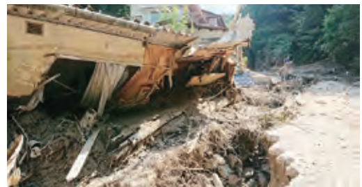
西日本豪雨で発生した土石流で被災した家屋
