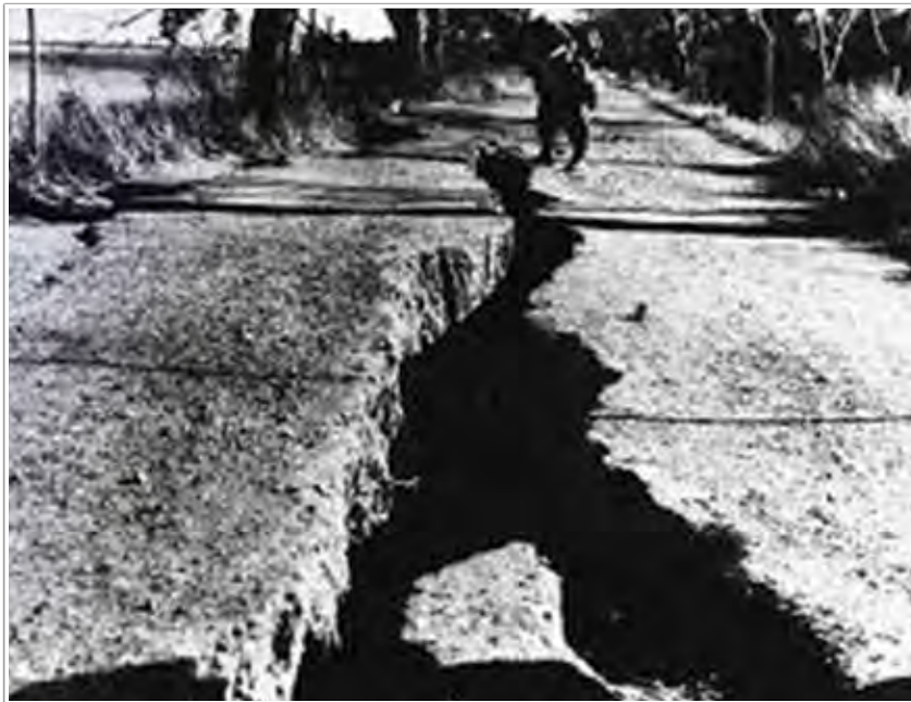
東南海地震で生じた地割れ(三重県桑名市)
