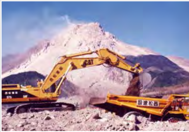
写真-3 無人化施工による警戒区域内での除石 (1994年4月11日)(松井宗廣氏撮影)
