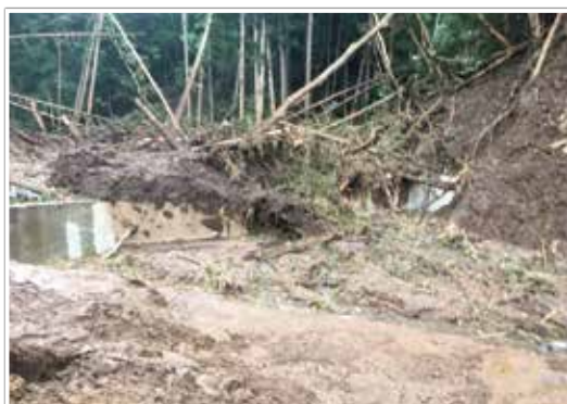
写真3 捜索現場の上流の堰堤の堆積土砂 (この奥に湛水) (10月14日11時頃)
