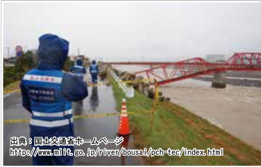
写真3 長野県上田市の落橋した鉄道橋
