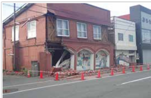
安平町被害状況
