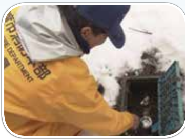
新潟県佐渡市では異常気温で凍結が原因の 水道管破裂、約 1 万世帯が断水（1 月 29 日）
