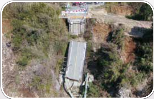
崩落したままの阿蘇大橋
