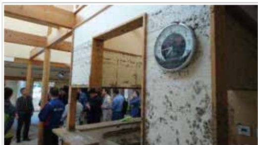
写真1 台風第10号災害による高齢者施設の被災
