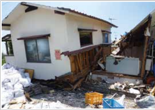
倒壊した家屋
