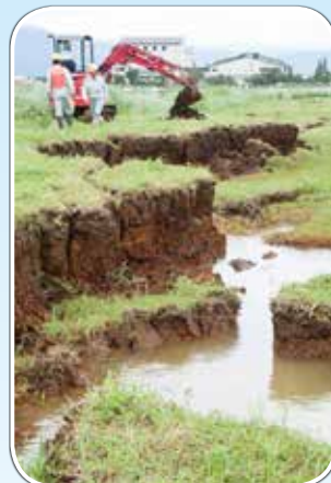
阿蘇市の地割れの様子
