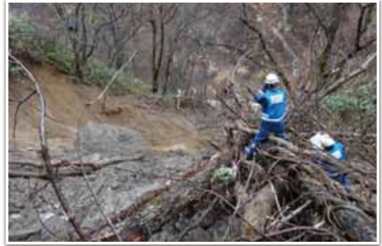
斜面崩壊箇所の調査（H26長野県北部地震）
