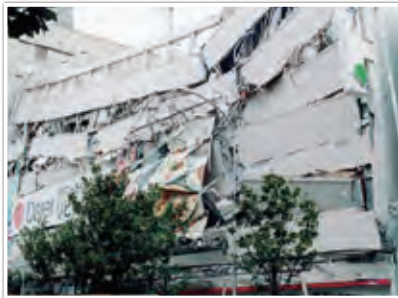
三宮のビル倒壊現場
