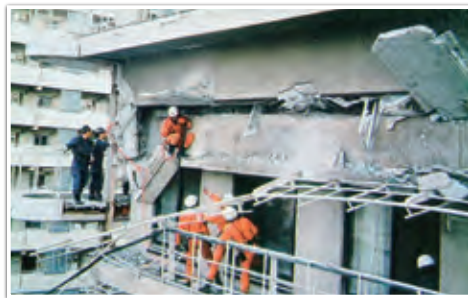
長田区西市民病院の救出現場
