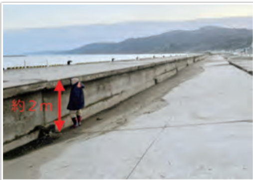
岸壁背後の沈下（輪島港）
